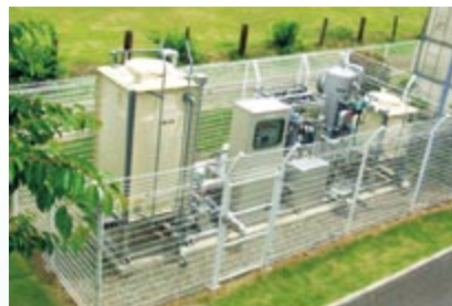
地下水膜ろ過システム
